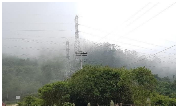
Sector Subestación Nueva Esperanza X: 4857877,95 Y: 2063296,09
